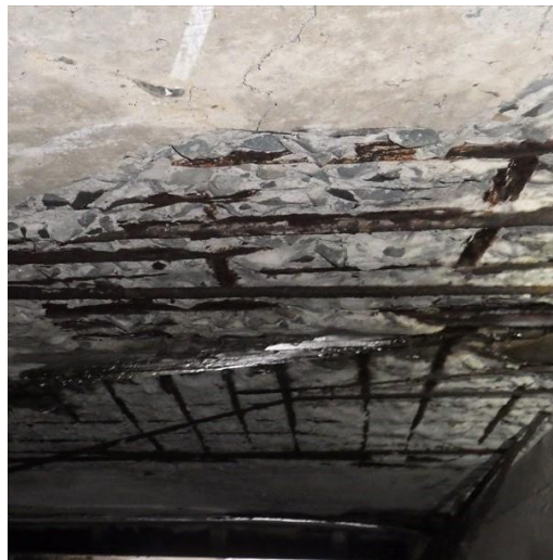
写真1：床版の鉄筋露出（健全度判定Ⅲ）
