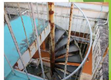
⑥外部階段の劣化
