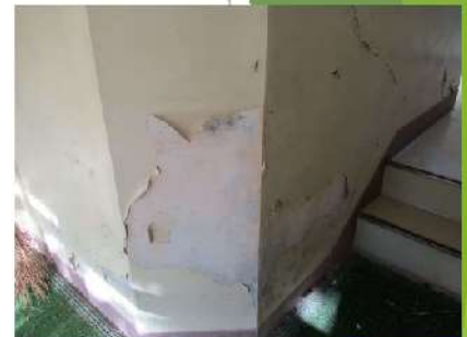
③仕上げ材の劣化
