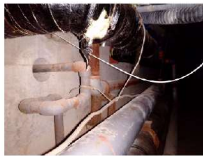
②腐食した配管
